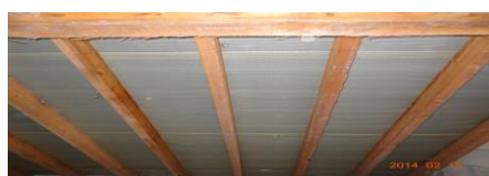
Ebene der Dacheindeckung ungedämmt
