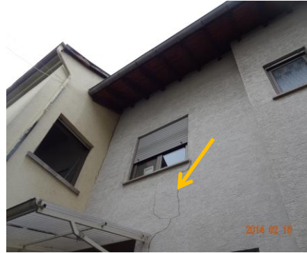
Rissbildung am Anschluss zum Bestand
